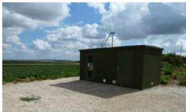
Intégration des deux postes de livraison.
